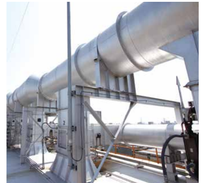
建屋集塵装置
