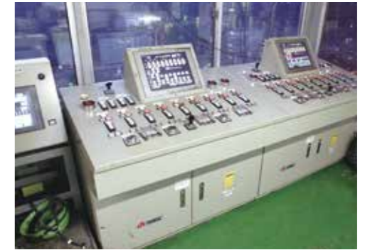
圧延中央操作室
